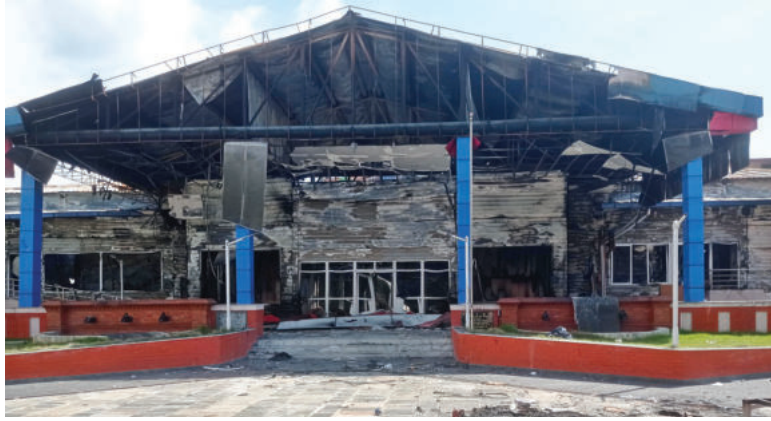
आन्दोलनका क्रममा आगलागीबाट ध्वस्त भएको प्रदेश सभा भवन।
